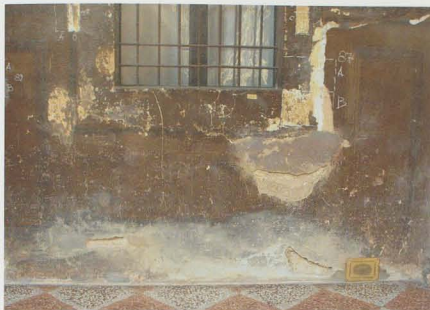
Fig. 1. Lato settentrionale del quadriloggio inferiore, arcata V. Degrado delle stuccature eseguite a cemento.
