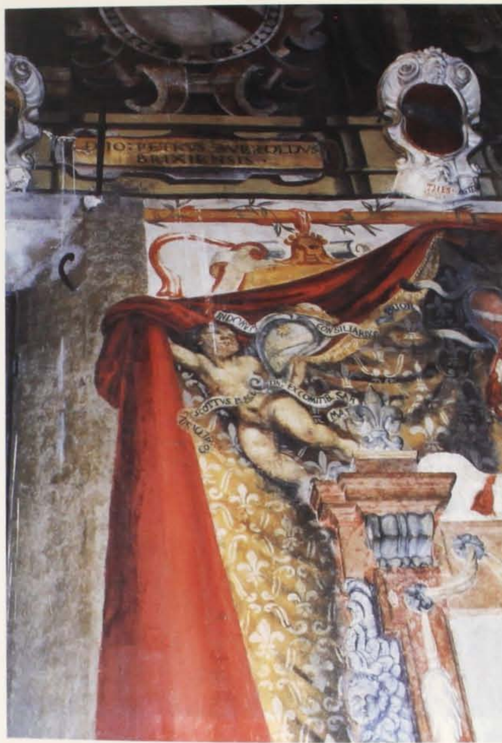
Tav. 3. Effetti della fuoriuscita della resina consolidante (applicata all'esterno del muro meridionale dello Stabat Mater) sul monumento Farnese (foto eseguita nel dicembre 2002); la pulizia del monumento è stata eseguita nei primi giorni del 2003.
